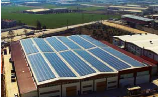
DENİZLİ MERKEZFENDİ 600 kWp - 2016
